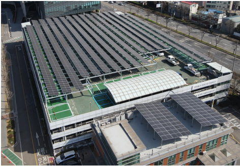
인천 사업장 태양광 발전 설비
