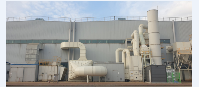
군산 폐열 재활용 열교환기
